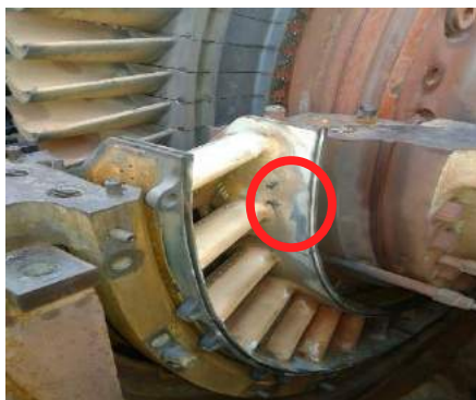
تخریب پوشش سد حرارتی پره ها:
